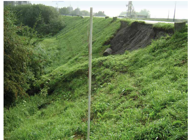
Micro-instabiliteit zichtbaar in de praktijk.
